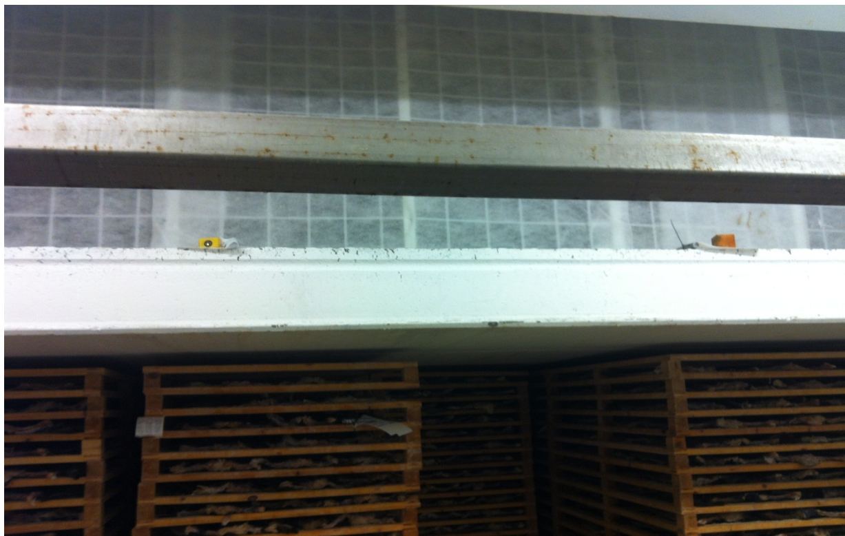
Figur 8: Plassering av logger over mesanintak. Filterduken er synlig over mesanintaket.
